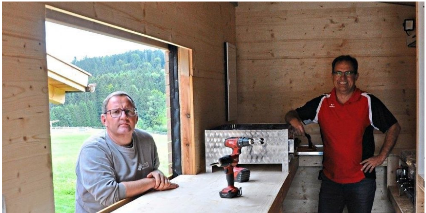
Endspurt beim Innenausbau: Stefan Gigl, Vorsitzender des Dorfvereins (li.) und die weiteren Helfer sind stolz auf ihr Werk.
